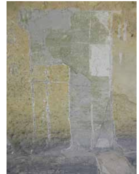
Krnov, synagoga, stratigrafie omítkových vrstev na západní fasádě (foto Hana Pavelková, 2013).
