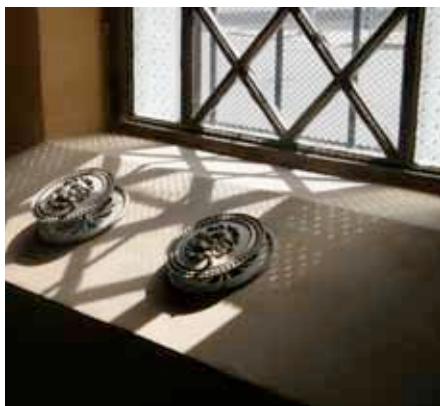
Krnov, synagoga, detail nasávacího ventilačního zařízení pod okny sálu synagogy (foto Hana Pavelková, 2013).
