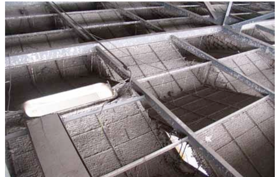
Detail rubu stropního podhledu odbavovací haly s otvory pro osvětlení a větrání (foto Martin Strakoš, 2011).
